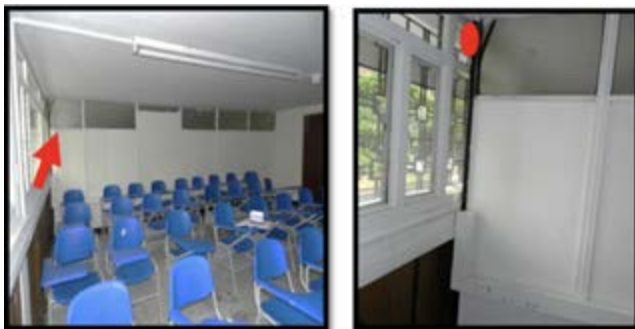
Espacios de aire entre la pared que divide el aula C291 y C220, y la pared de fachada ubicada el extremo de la calle 72
